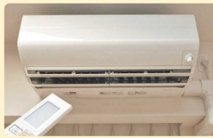
エアコンの電気使用量は約750w
